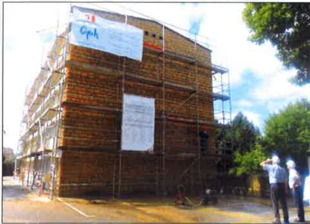
Travaux de toiture sur l'immeuble de la rue Général-Leclerc, avec pose d'isolation thermique. Photo RL
